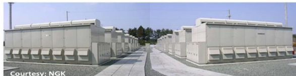
شکل ۳ ظرفیت ذخیره سازی ۳۴ مگاوات ساعت در سیستم باتری NaS
